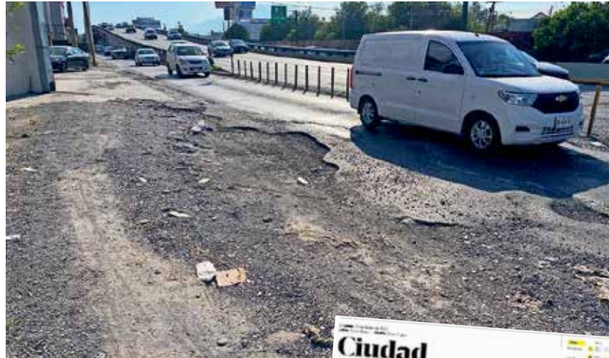
Las zonas más afectadas por los baches pertenecer
